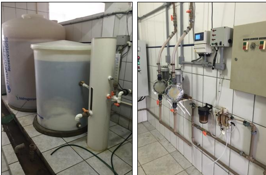
Figura 23 – Gerador e dosador de Cloro
