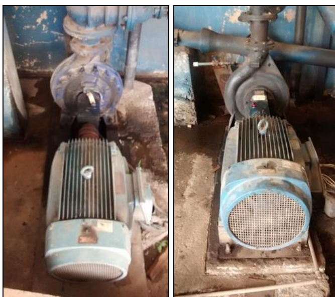
Figura 28 – Bombas de Recalque Bairro Rosário
