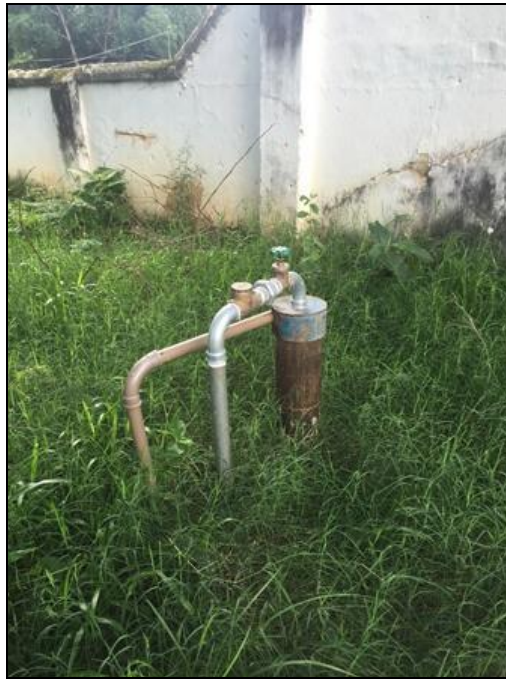
Figura 8 – Poço – Rua Expedicionário Jorge – ao lado da Elevatória de Água Tratada
