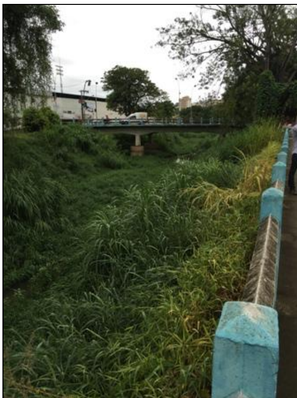
Figura 148 – Área Problema 2: excesso de vegetação no rio nesse trecho
