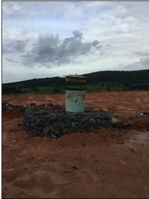
Figura 80 – Dreno de gás
