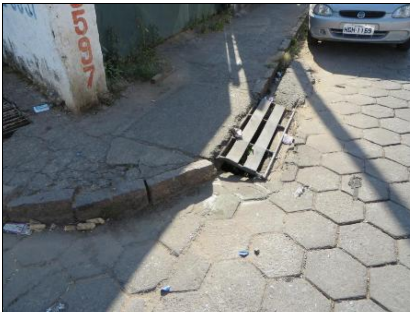
Figura 119 – Boca de lobo em Formiga (tipo 1)
