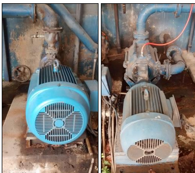
Figura 27 – Bombas de Recalque do Cristo e Engenho da Serra
