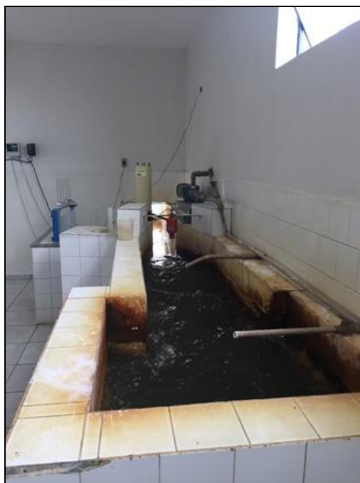
Figura 16 – Chegada de Água bruta – ETA
