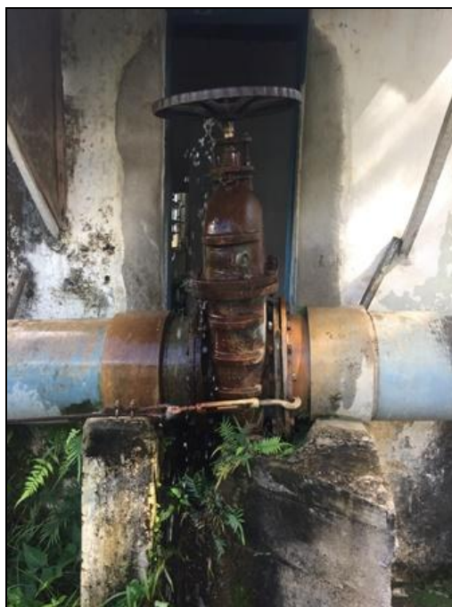
Figura 33 – Vazamento de água no registro – ERAT Rua Expedicionário Jorge
