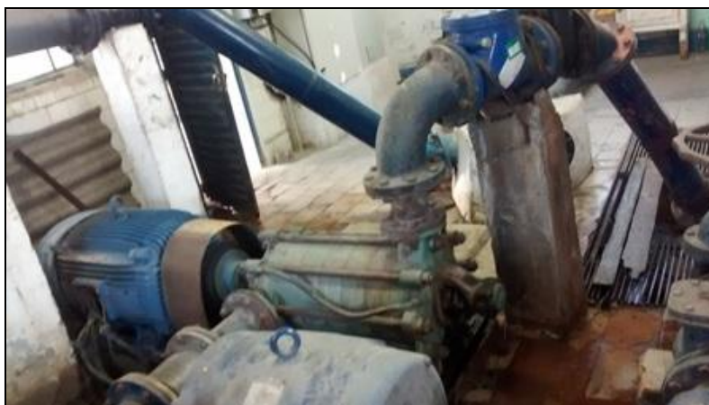
Figura 30 – Bombas de Recalque Novo Horizonte
