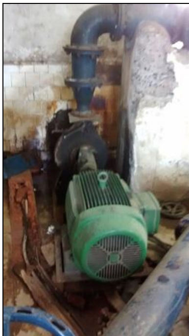
Figura 31 – Bombas de Recalque Picolé
