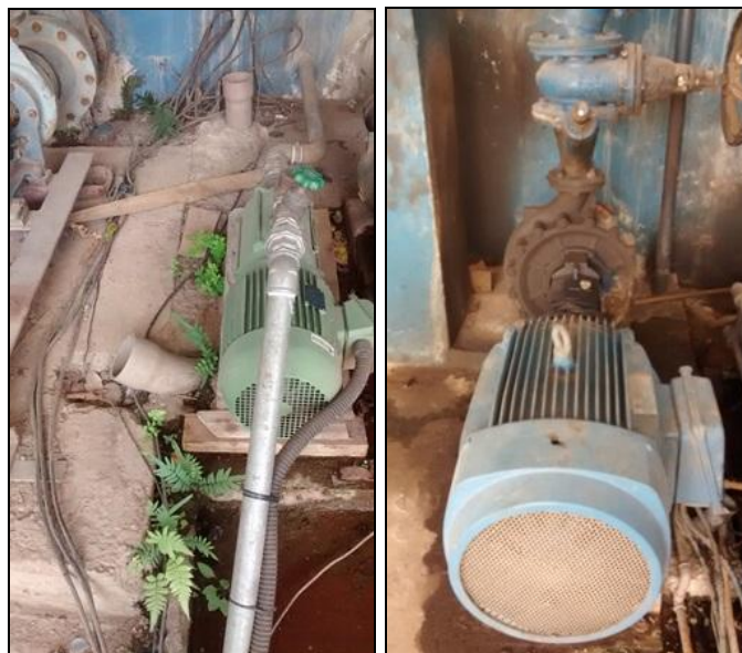
Figura 29 – Bombas de Recalque Bairros Serra Verde e Santa Luzia
