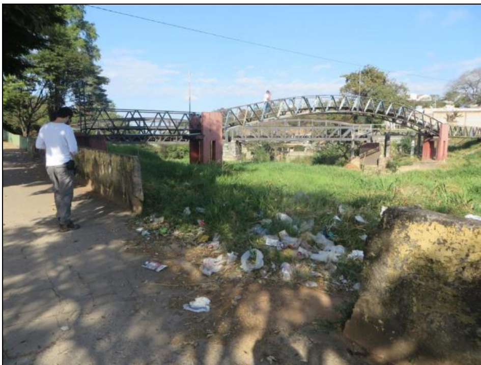
Figura 142 – Contenção danificada e acúmulo de resíduos sólidos no local Fonte: Ministério de Minas e Energia
