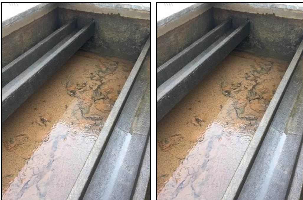
Figura 21 – Processo de Lavagem dos Filtros
