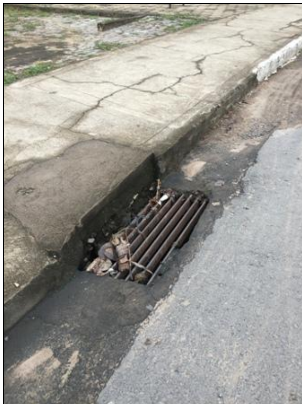
Figura 156 – Área Problema 6: boca de lobo existente no local
