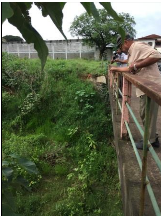
Figura 162 – Área Problema 9: ponte afetada pelo alagamento
