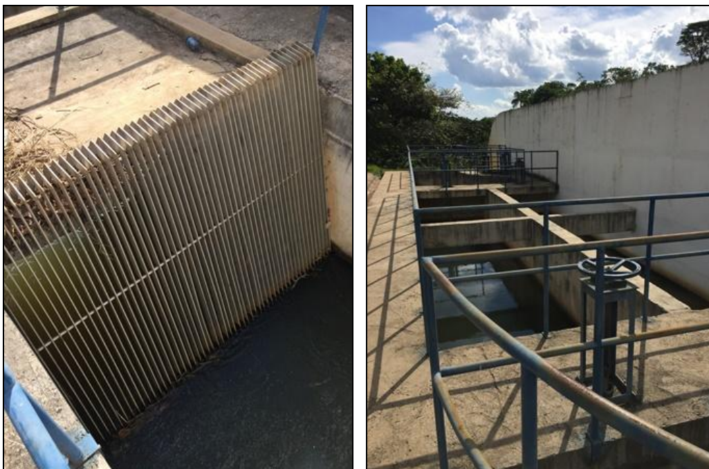
Figura 6 – Gradeamento e Canal de captação de água Bruta
