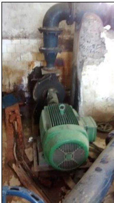
Figura 31 – Bombas de Recalque Picolé
