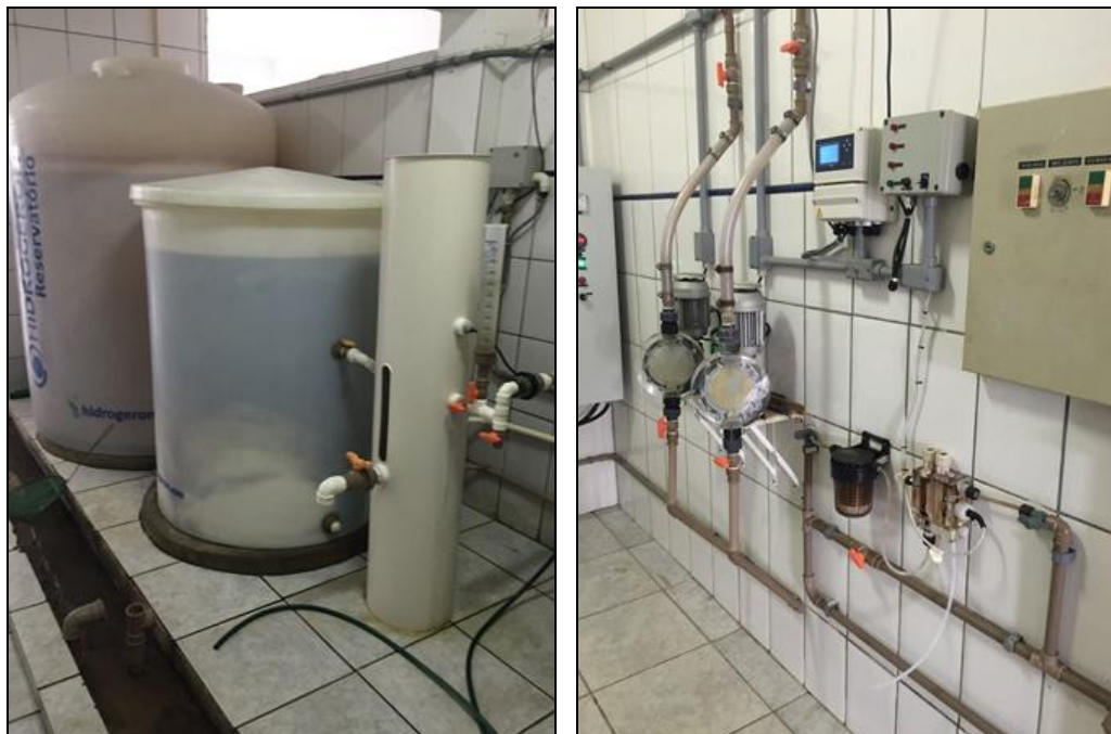
Figura 23 – Gerador e dosador de Cloro
