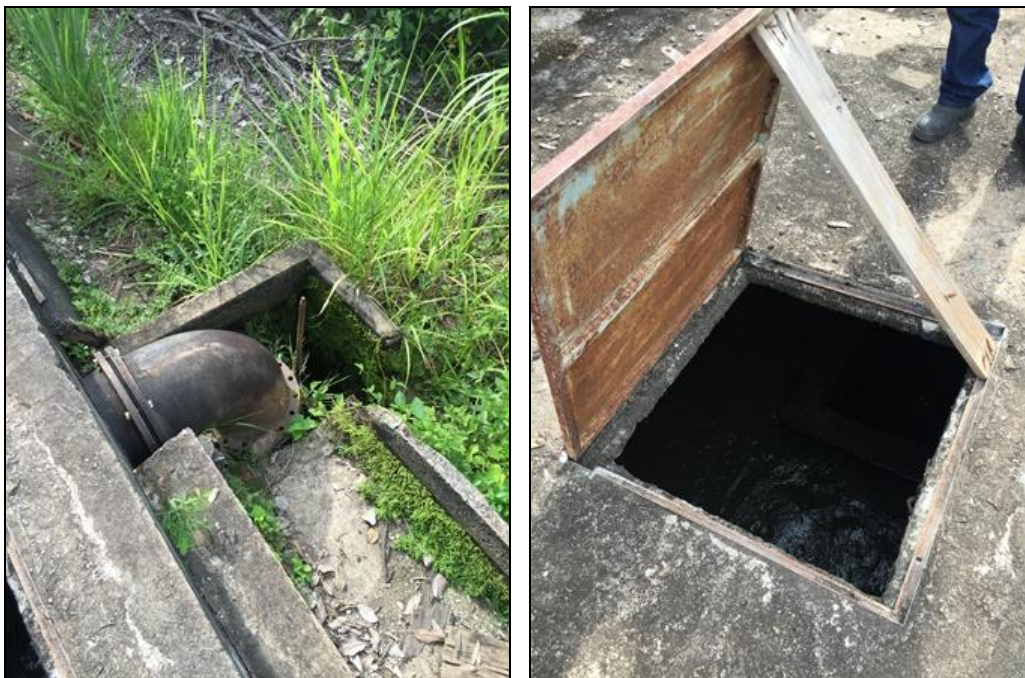
Figura 12 – Tubulação e caixa de chegada de água bruta na ERAB
