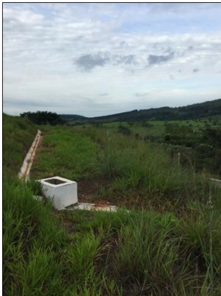
Figura 82 – Drenagem pluvial definitiva
