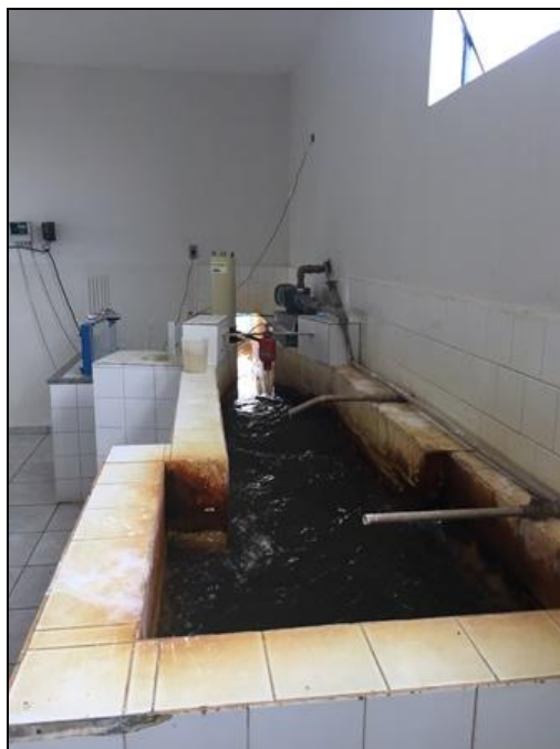
Figura 16 – Chegada de Água bruta – ETA
