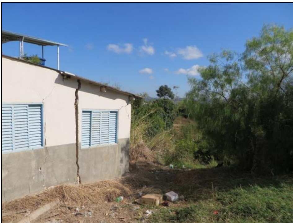
Figura 166 - Residência edificada na base de feição erosiva Fonte: Ministério de Minas e Energia
