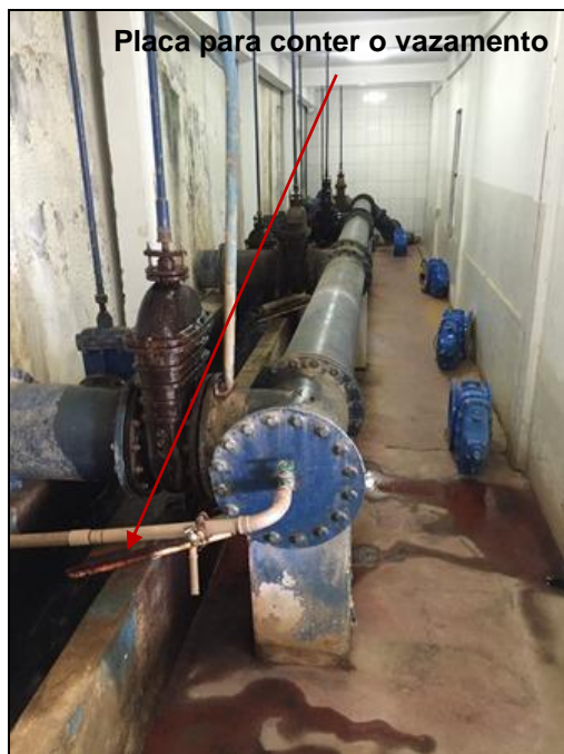
Figura 32 – Vazamento de água no registro – Filtro Descendente - ETA
