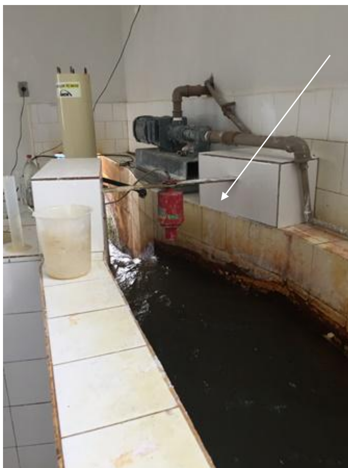
Figura 34 – Medidor de Vazão Ultrassônico – Entrada da ETA
