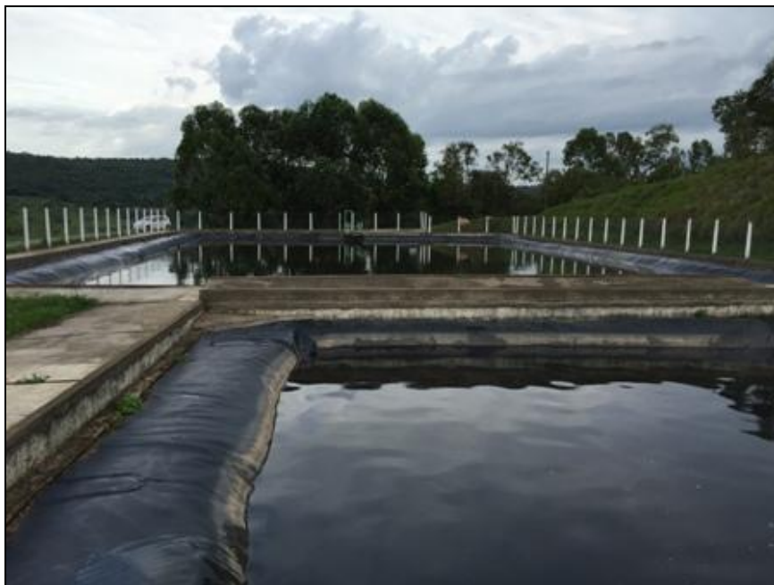
Figura 81 – Sistema de lagoas (tratamento do percolado)
