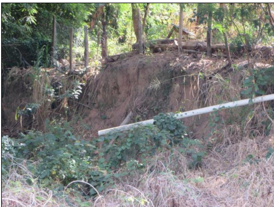
Figura 167 – Lançamento de esgoto diretamente sobre os taludes Fonte: Ministério de Minas e Energia
