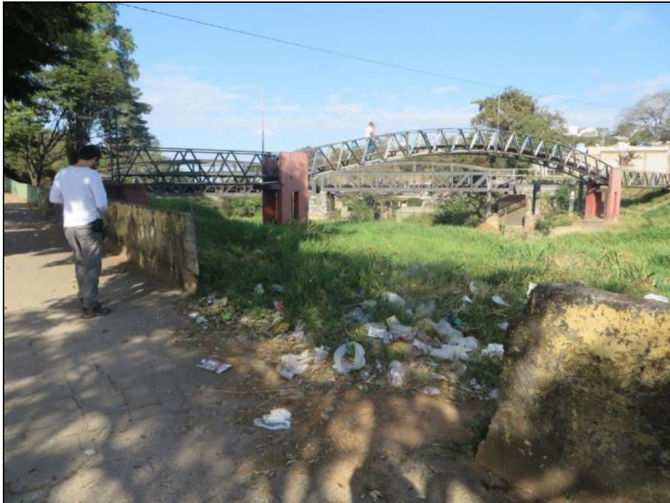
Figura 142 – Contenção danificada e acúmulo de resíduos sólidos no local Fonte: Ministério de Minas e Energia
