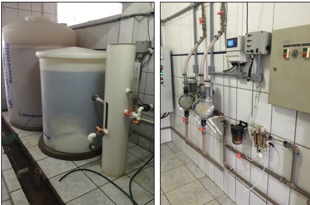
Figura 23 – Gerador e dosador de Cloro
