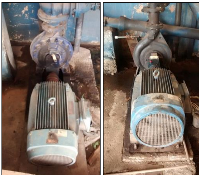
Figura 28 – Bombas de Recalque Bairro Rosário
