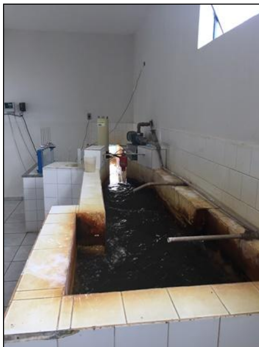
Figura 16 – Chegada de Água bruta – ETA
