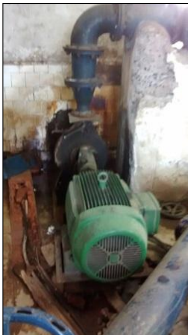
Figura 31 – Bombas de Recalque Picolé
