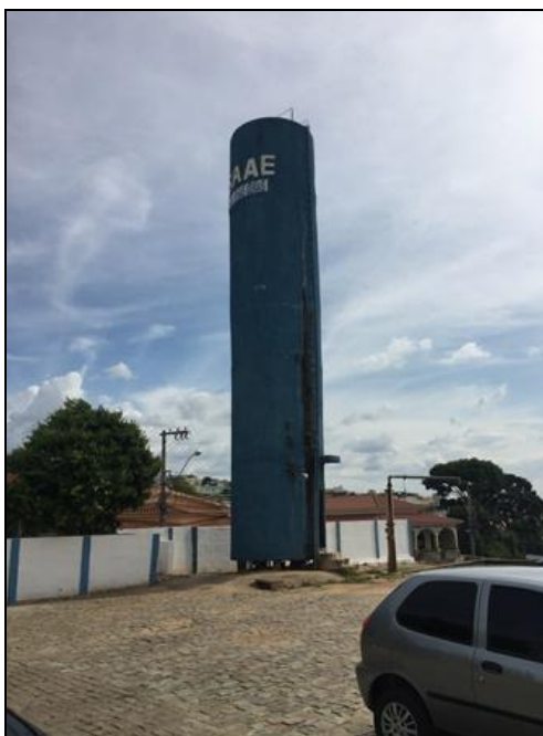
Figura 26 – Reservatório Metálico – ETA
