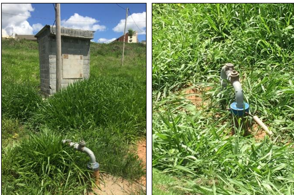
Figura 10 – Poços –Rua Salgado Filho – Bairro Jardim das Acácias
