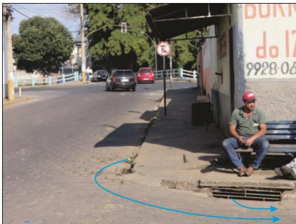
Figura 144 – Rua inundada pelo retorno da água do rio por meio do sistema de drenagem Fonte: Ministério de Minas e Energia
