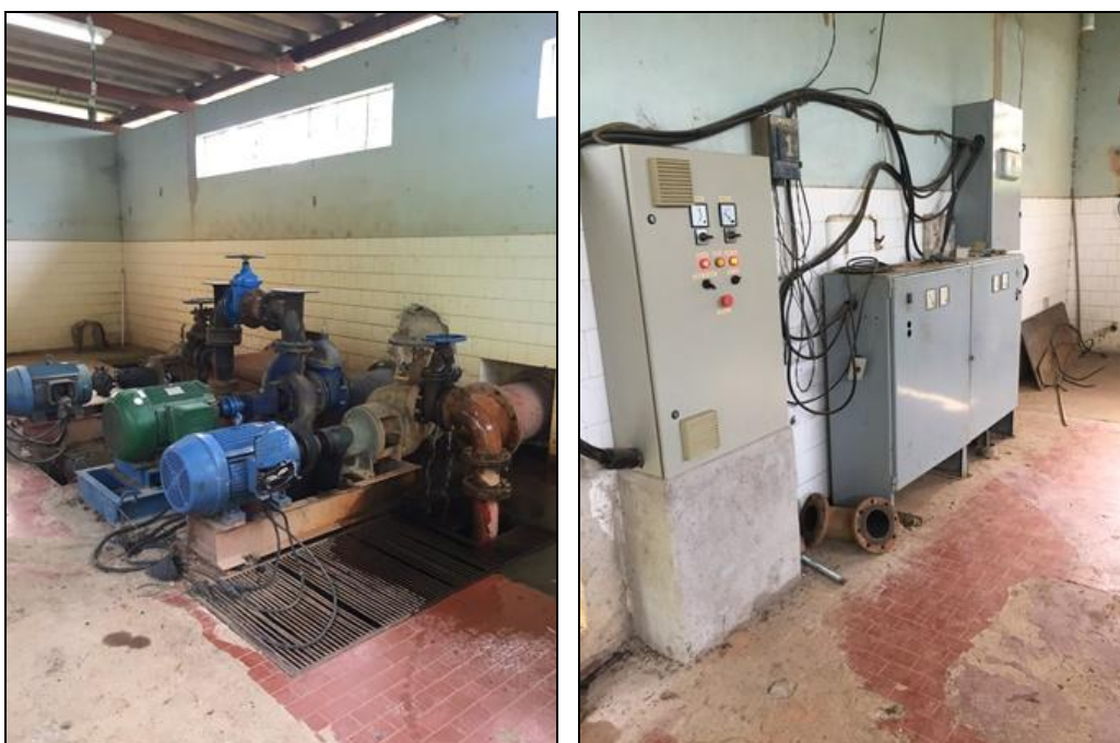
Figura 13 – Conjuntos Moto-Bombas e painel de controle da ERAB
