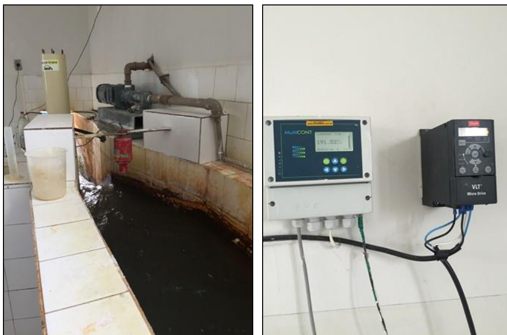
Figura 17 – Calha Parshall Medidor de Vazão Ultrassônico – Entrada da ETA
